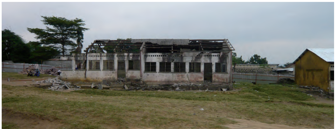
Figures 1, 2 et 3. Ecoles à réhabiliter
