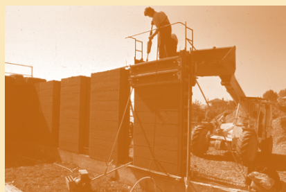
Le pisé actuel coffrages grimpants et fouloir pneumatique Le Panier Fermier, Drôme.
